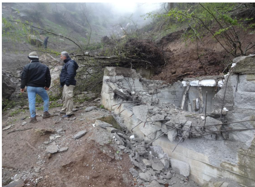
شکل-۱۹- تخریب مخزن بتنی ذخیره آب روستا
