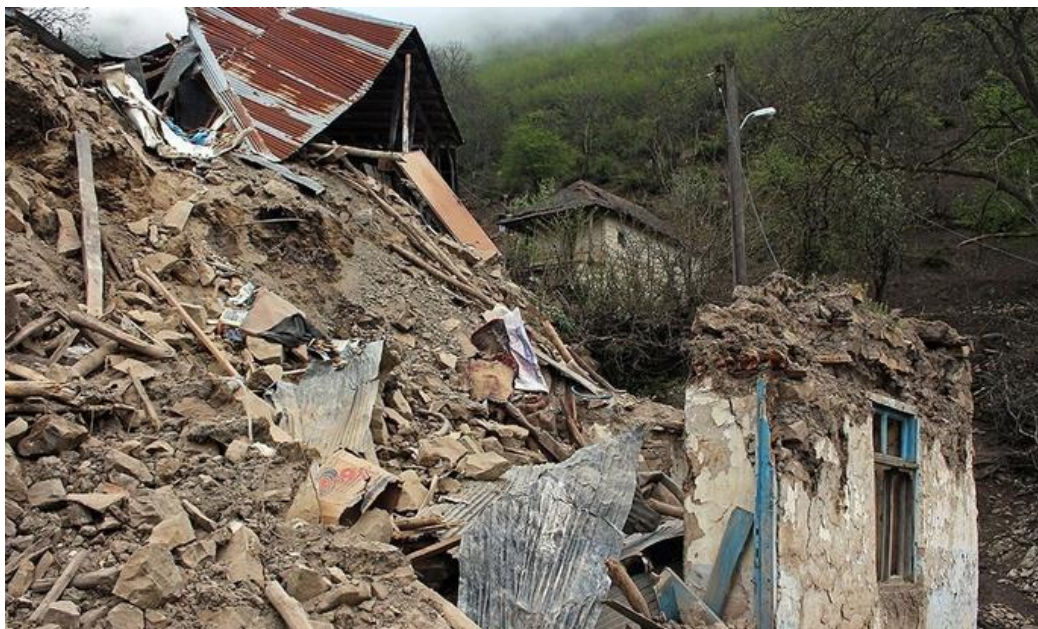
شکل-۱۴- تخریب منازل مسکونی (دید به سمت باختر)
